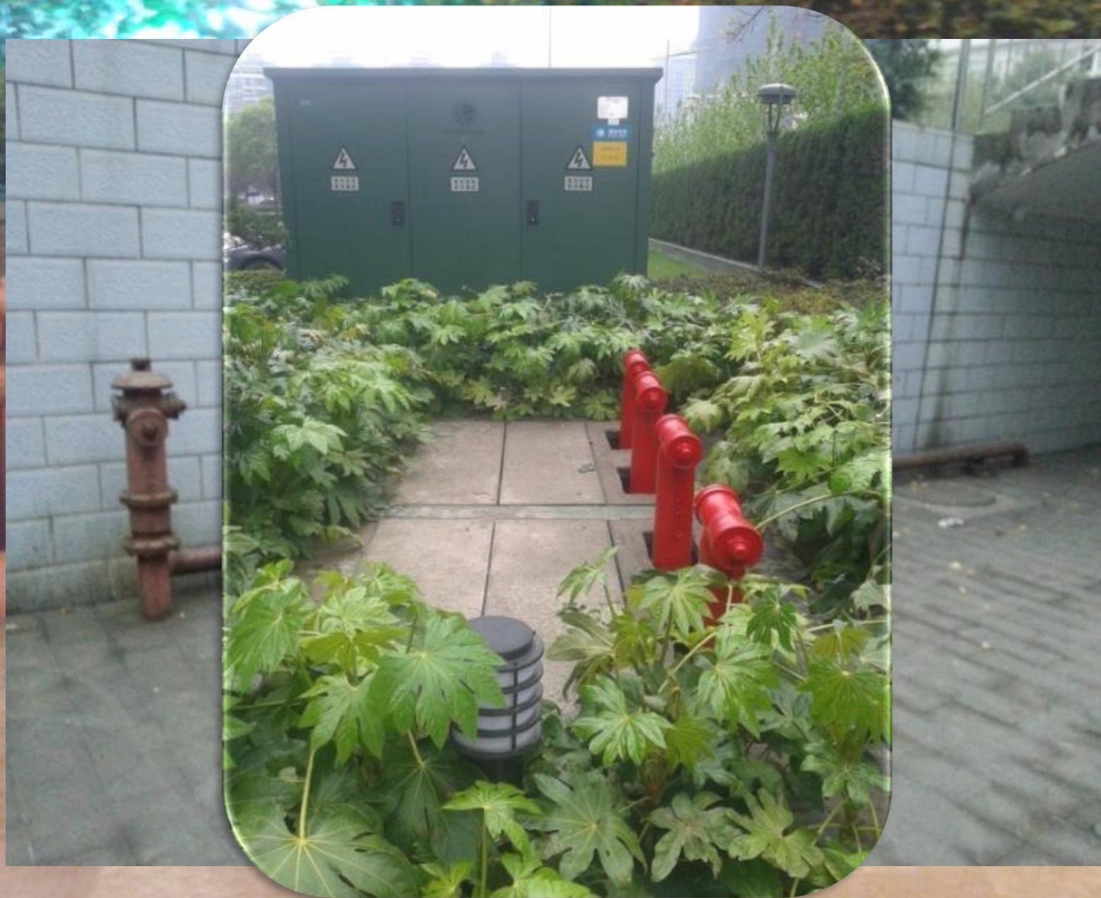
消防水泵接合器设置位置不符合实战需要。
